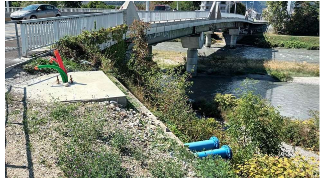
Illustration 5.5: Tuyaues (bleus) du réseau d'exhaure en sortie de traversée de bretelle d'autoroute réaménagée, après pont autoroutier
