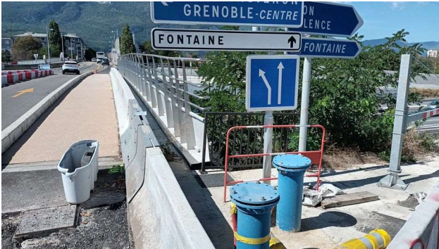
Illustration 5.4: Tuyaues (bleus) du réseau d'exhaure en sortie de traversée de bretelle d'autoroute réaménagée, avant pont autoroutier
